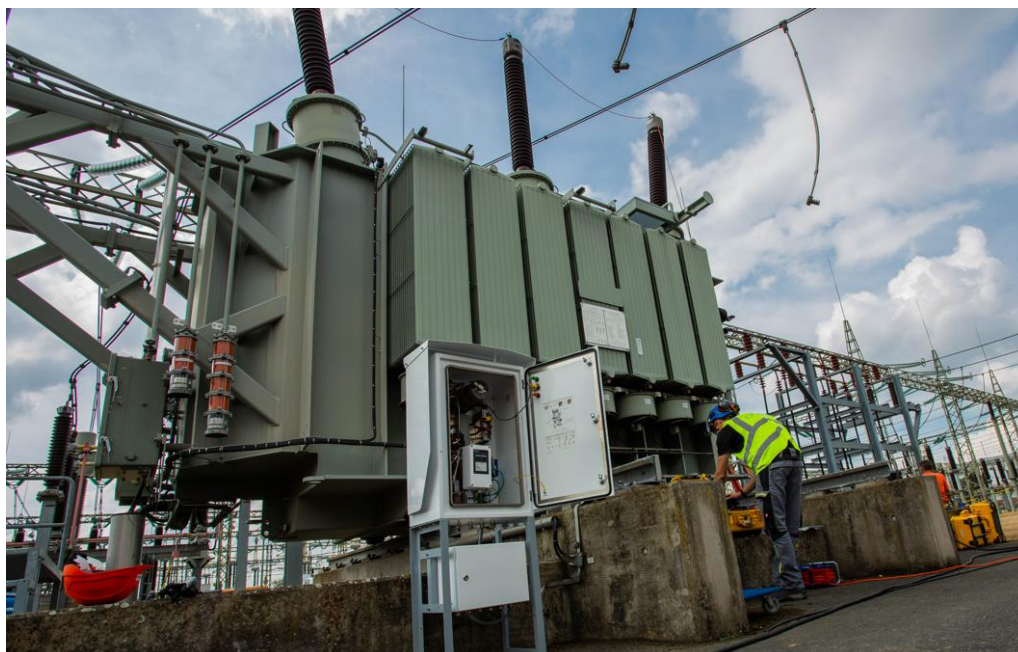
Abbildung 7. Beispielhafte Installation eines Gerätes M7 (OPT100, VAISALA)
