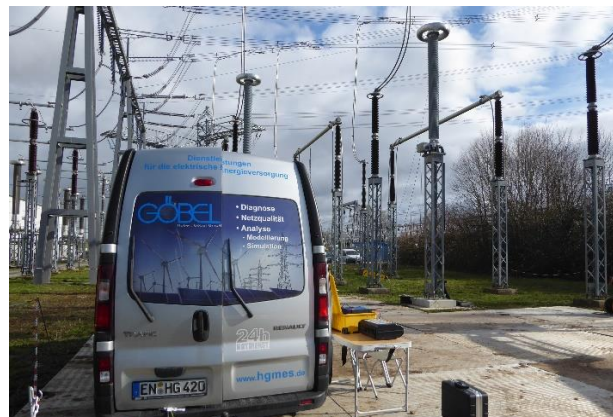
Abbildung 4. Beispielhafte Darstellung eines Messeinsatzes zur invasiven Verifikation eines RC-Teilers in einer 400 kV-Schaltanlage
